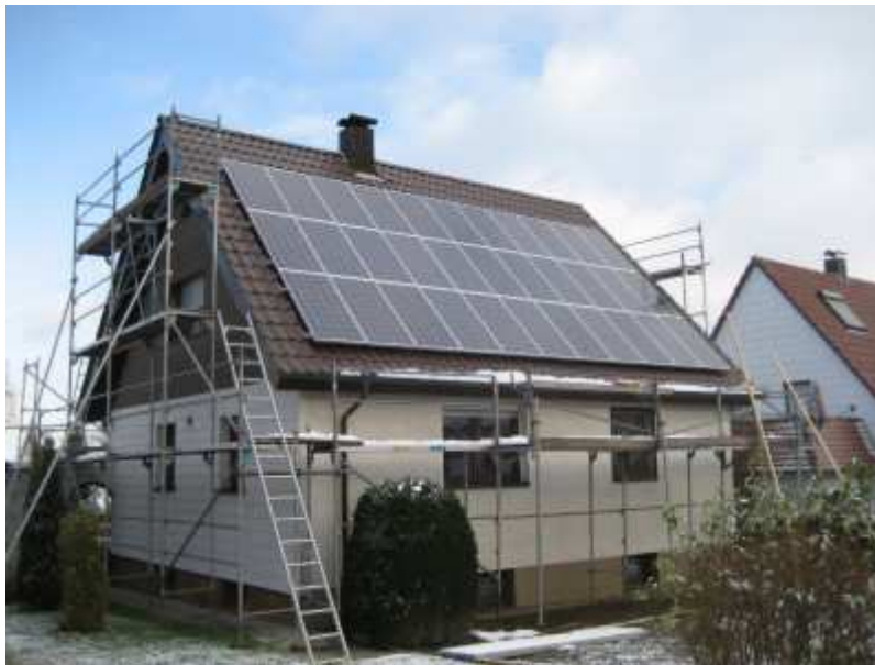
Abbildung 5: PV-Dachanlage in Hattenhofen (Bayern) 18
